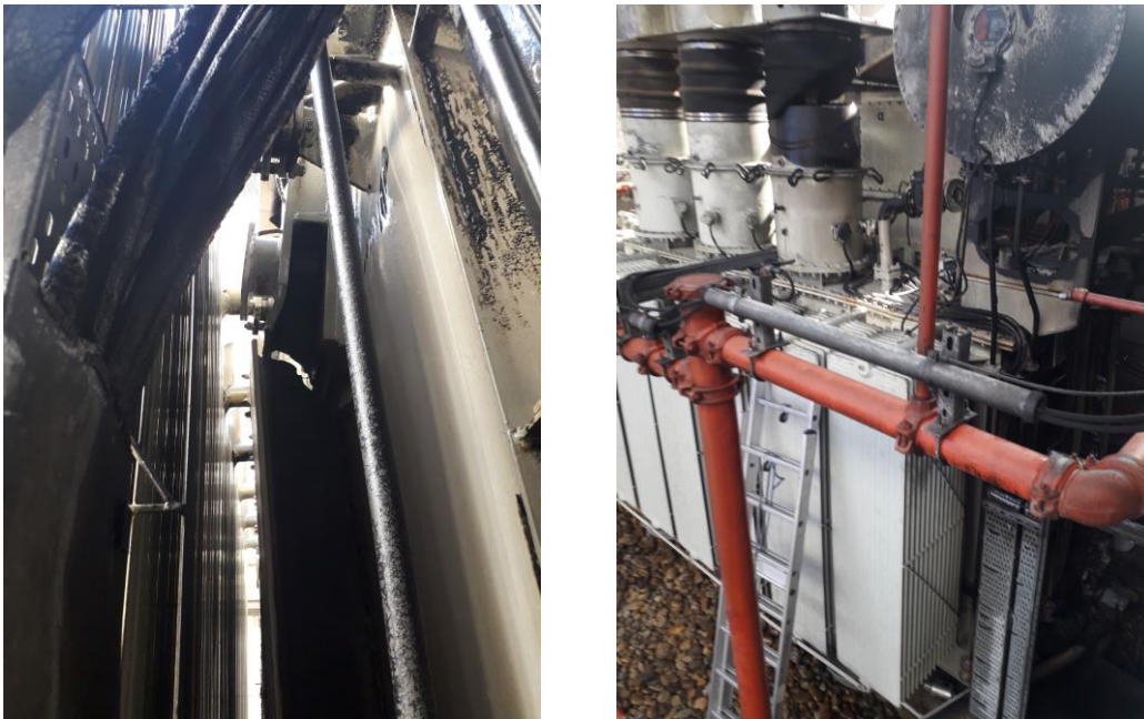
Фиг. 3. Части от силов трансформатор, след авария на стъпален регулатор
