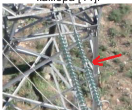
Снимка 6. Аерофотоснимка на въздушна линия високо напрежение (ВЕЛ) – констатирана липса на изолатор от височина 120 м. [9]
