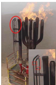
Снимка 3. Проверка на факела без прекъсване на работа, наличие на корозия, проверка на конструкцията [15].
