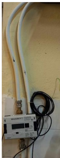
Топломер на консуматора
