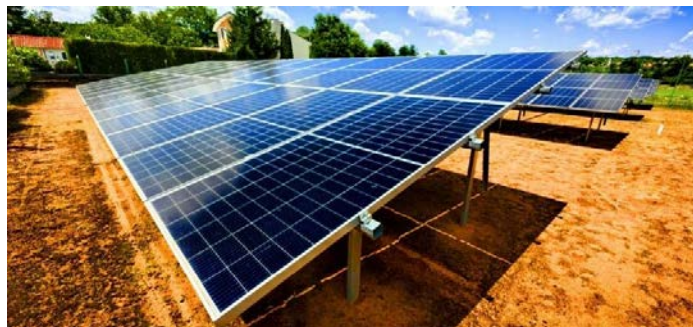
Фиг. 1. Фотоволтаична централа 30 kWp в гр. Килифарево
