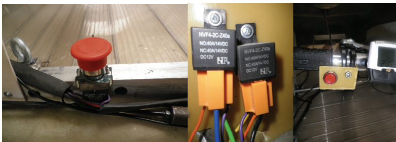
Фиг. 4. Аварийен бутон за изключване и релета за управление на силовата верига
