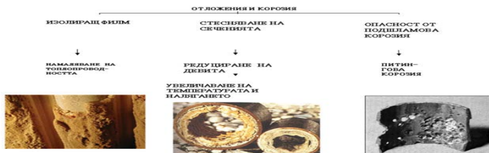
Снимка 9 Поражения от корозия
